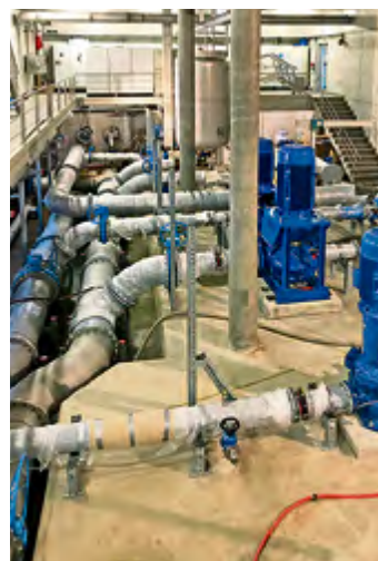
In dem zuvor leeren Bereich des Wasserwerkes stehen nun eng umschlungen von vielen neuen Leitungen die drei ebenfalls neuen blauen Reinwasserpumpen.
