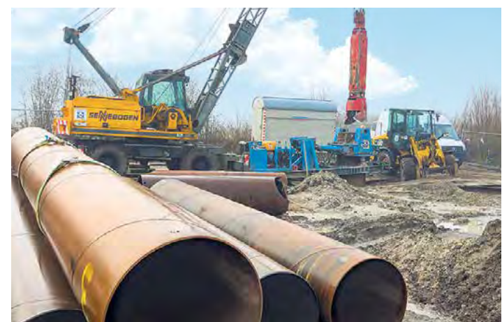
Mit einer Trockenbohrung wurden die ersten Meter für den Brunnen bereitet. Später wurde das üblichere Lufthebeverfahren angewendet.
