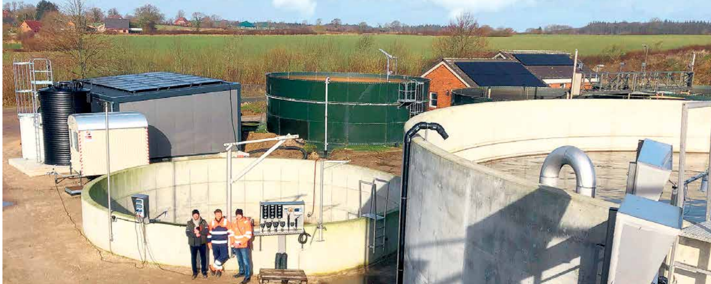
Die neue Kläranlage Freienwill ist inzwischen gut eingefahren. Die Arbeiten an den Außenanlagen schließen sich an.
