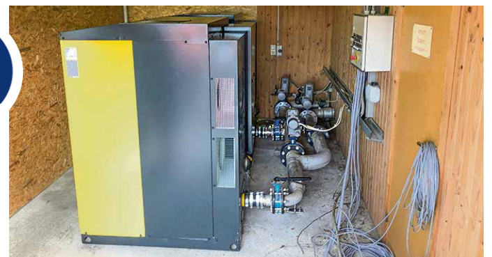
Gut 1,80 Meter hoch ist der gelb-schwarze Kasten der die neue Kompressoren-Technik enthält, mit deren Hilfe der WV Nord nun den hohen Energiebedarf um 30 Prozent reduziert.
